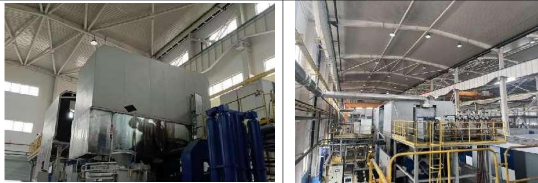
集气罩+油雾净化装置
